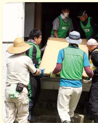
浸水した荷物の運び出し作業(8/18)
